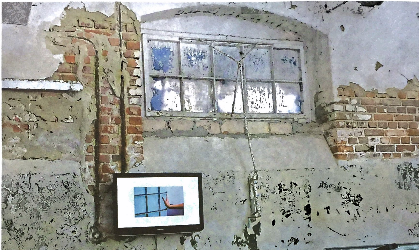
Die alten Futterställe, Austragungsort der Ostrale, sind baufällig. Am Jahresende endet die Genehmigung für das Gebäude als Veranstaltungsort.
